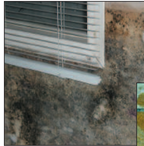
Moisissures sur un mur causées par une infiltration d'eau.
